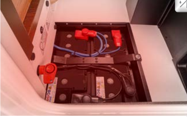
Batteriezentrale beheizt mit Strom Hauptschalter. Serie: Gel-Batterien 2 x 80 Ah, gut zugänglich im Außenstauraum auf der Beifahrerseite positioniert, optional Lithium-Ionen-Batterie, 90 Ah inklusive Batteriecomputer und separatem Touch-Display
